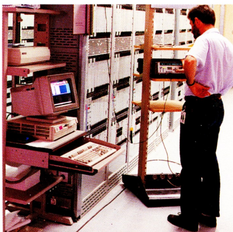
Equipements de transmission Les Concentrateurs
