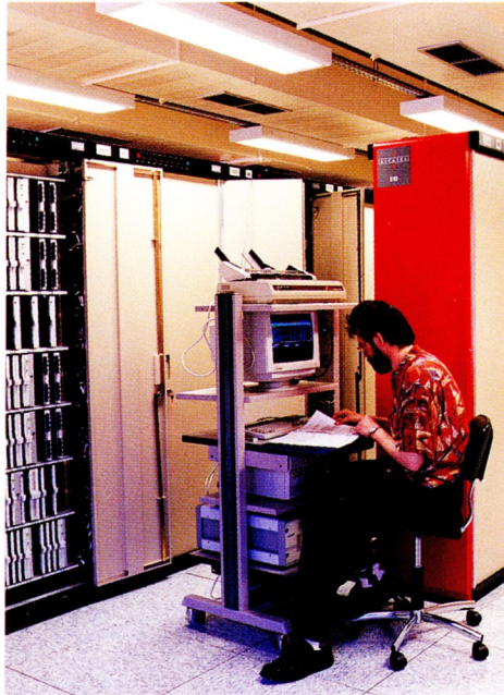
Salle autocommutateur du CIA
